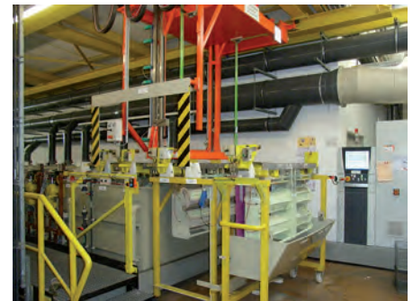
Trommelanlage für die galvanische Metallabscheidung, die vollständig mit elektrischer Energie betrieben wird
